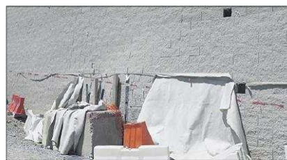
Les fissures cachées du mur de soutènement, sur la RD6204.
