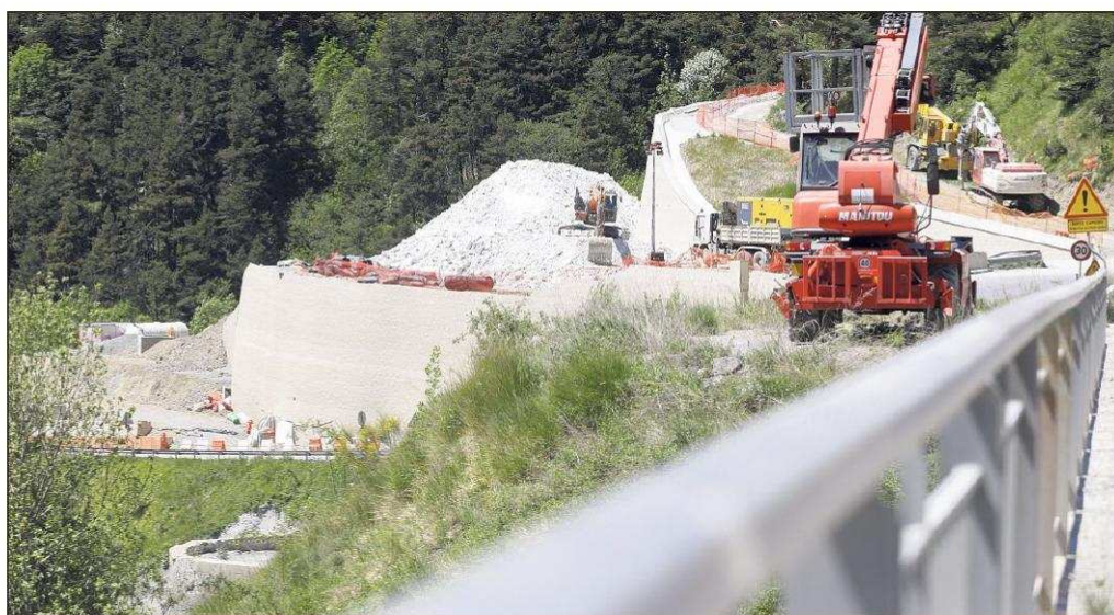
Au col de Tende, le mur édifié en aval du chantier (à gauche sur cette photo) inquiète autorités et experts.
